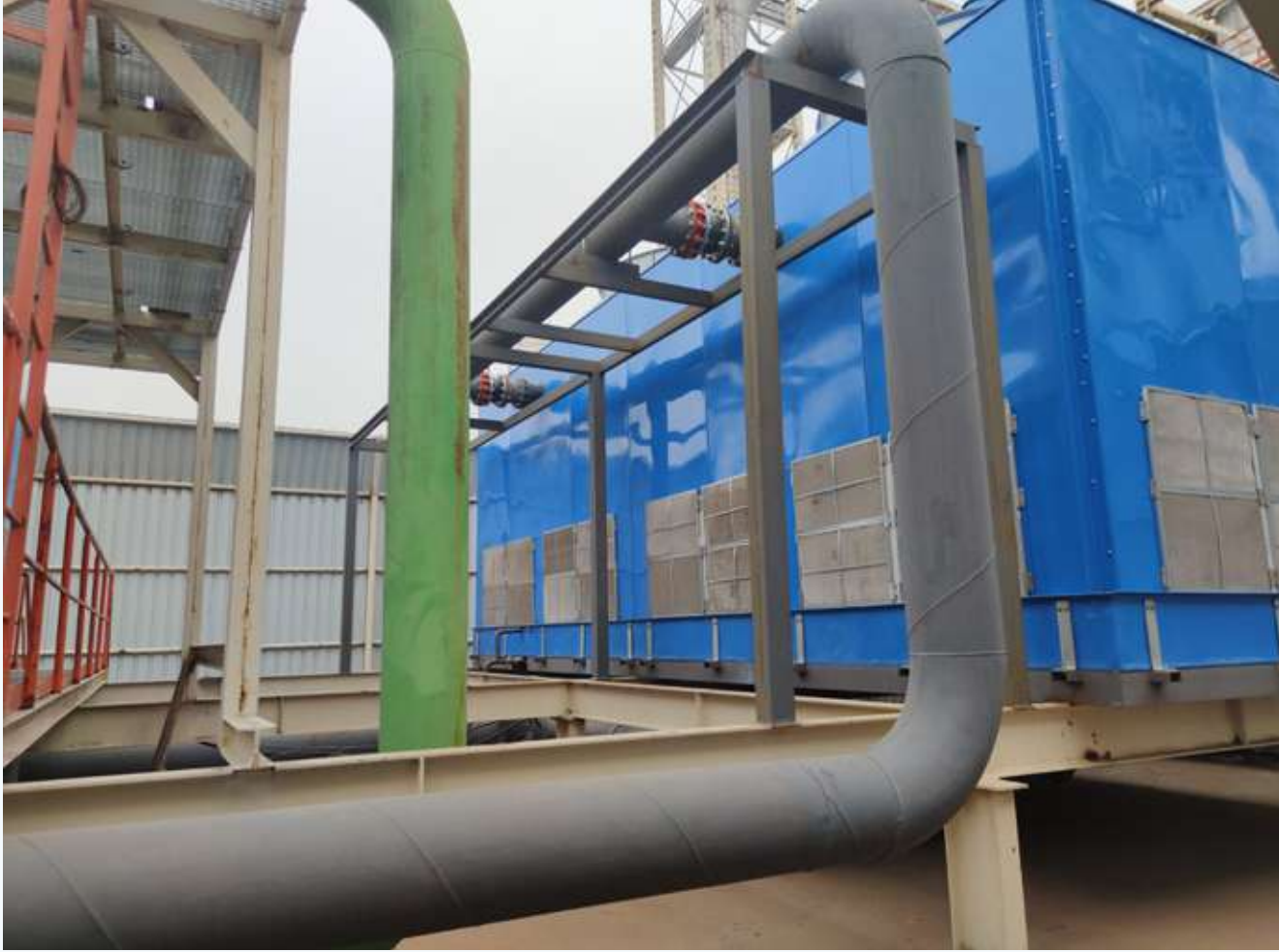
Su soğutma kule grupları
